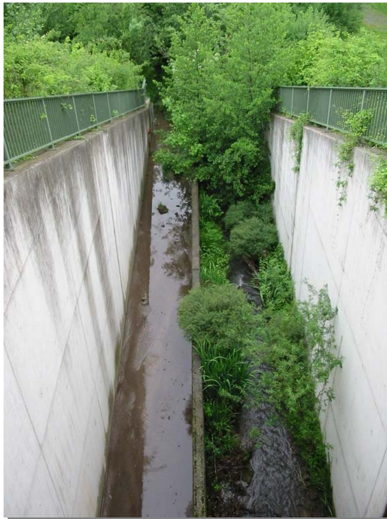
Abb. 56: Betriebsauslass (links) und Ökodurchlass (rechts) am HRB Ellbach
