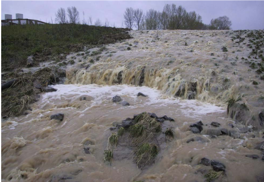
Abb. 44: Schadensfall durch Setzungen und daraus resultierenden Abflusskonzentrationen
