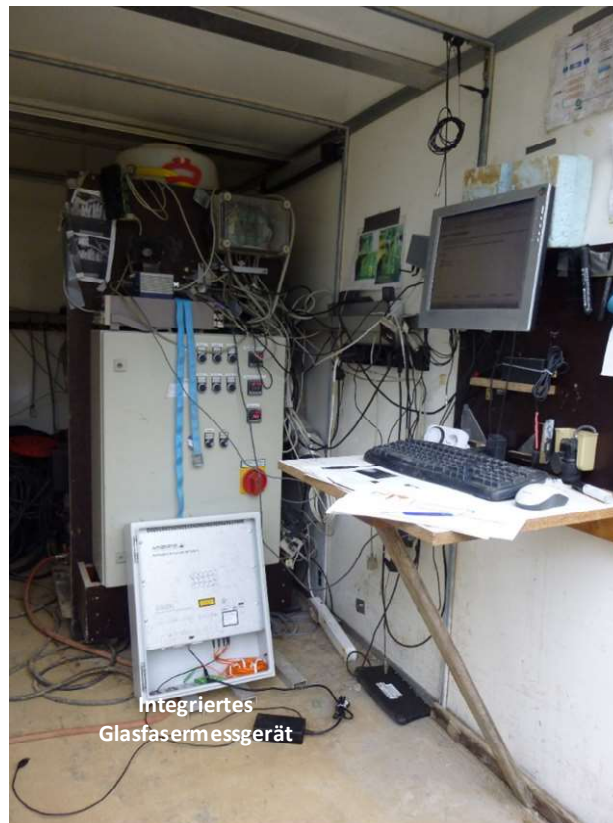
Abbildung 2 verwendete TRT Anlage mit eingebundener Glasfasermesstechnik.
