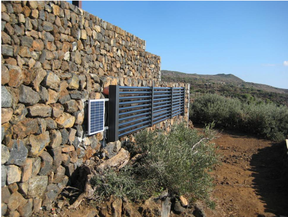
Abbildung 59: Kollektoranlage der Firma airwasol auf Pantelleria, Schrägansicht
