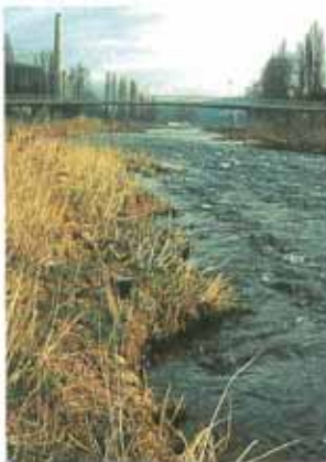
Abb. 40: Schäden an der Uferbefestigung (Aufn.: Universität Karlsruhe 1994).
