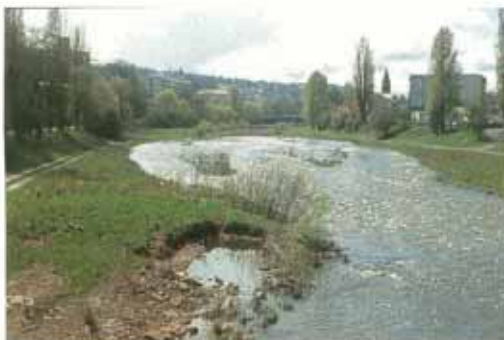
Abb. 44: Schaden hinter dem Ufervorsprung bei km 57+450 (Aufn.: Universität Karlsruhe 1994).
