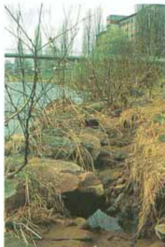
Abb. 48: Schaden zwischen Böschung und Bauweise Steinwurf mit Weidenstecklingen (Aufn.: Universität Karlsruhe 1994).
