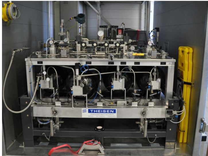
Abbildung 3: Ansicht der fertiggestellten Waagen-Wasserstoff-Tankeinheit
