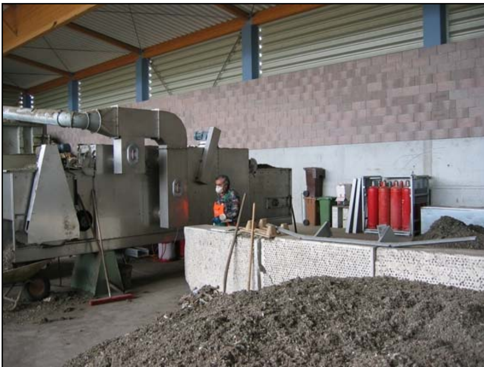
Abb. 11: Mix-Trocknung im STELA-Bandtrockner (bei Firma Bogenschütz, Grosselfingen)
