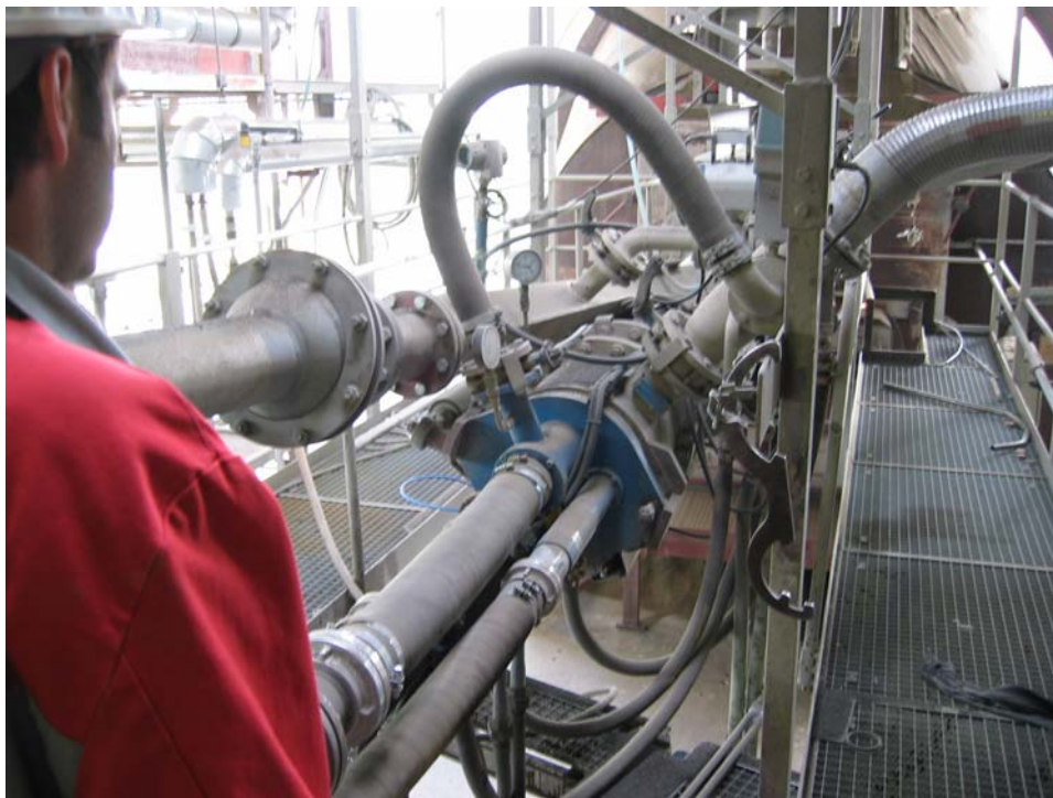
Abb. 24: Ansicht der Brennstoff-Einblasleitungen für Kohlenstaub und Erdgas in die Stirnseite des Zementofens. Die Rohrleitung mit dem kleinen Durchmesser ist die Ersatzbrennstoff-Blasleitung
