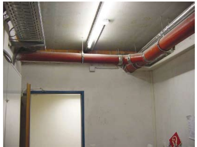
Abb. 67: Beispiel für ein unter der Kellerdecke abgehängtes Entwässerungssystem
