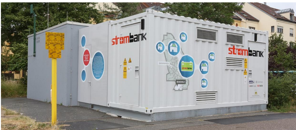
Abbildung 8: Der Batteriespeicher am Standort Rheinau
