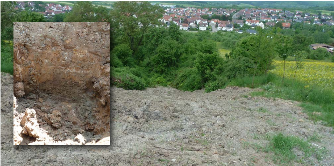
Abbildung 3.1: Verwendung von ungeeignetem Bodenmaterial, Auffüllung mit Verdichtung als schädliche Bodenveränderung
