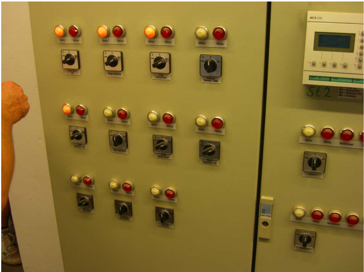
Abbildung 31 Steuerungstableau für die Heizungsanlage in Haus 5 der Brüder-Grimm-Schule
