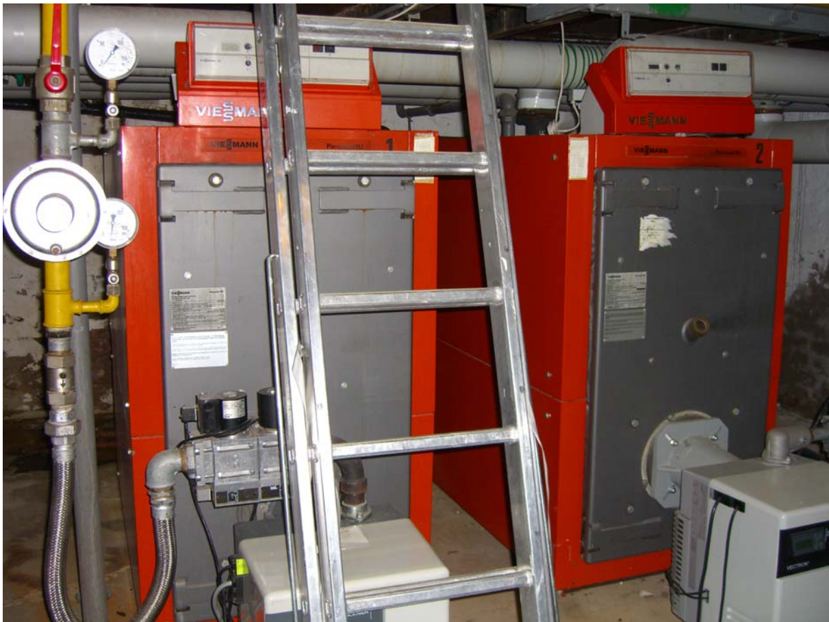
Abbildung 30 Heizanlage im Haus 1 der Brüder-Grimm-Schule
