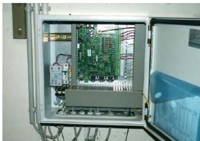
Abbildung 16 Smart Box, Innenansicht. Quelle: Hochtief 2007
