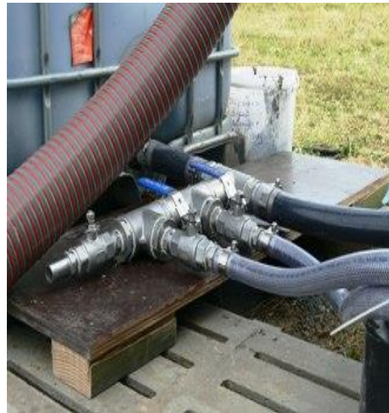
Abbildung 40: Durchflusstück mit 2 Anschlüssen zur Beschickung der Anlage
