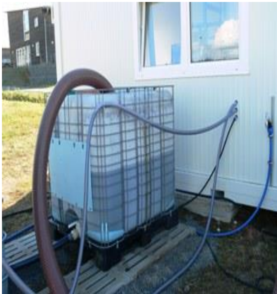
Abbildung 39: Zuflüsse vom IBC-Container zur Halbtechnik-Anlage
