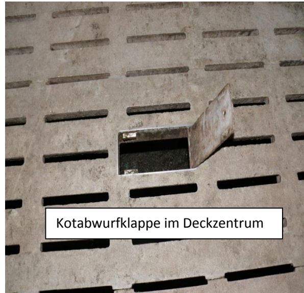
Abbildung 55: Kotabwurfklappe im Deckzentrum
