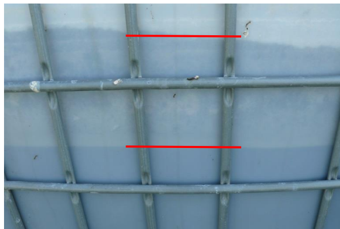
Abbildung 67: Schaumbildung im IB-Container von außen sichtbar
