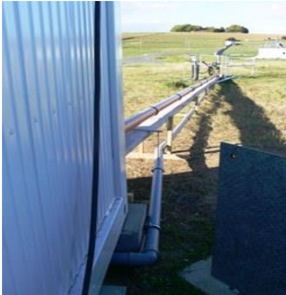
Abbildung 37: Abflussrohre für das Abwasser (grau) und behandelte Gülle (rot) zur Grube Nord
