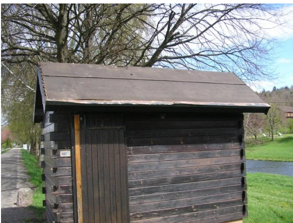
Bild 19: Pforzheim-Enz 2012-04-23 Gestohlenes Kupferdach
