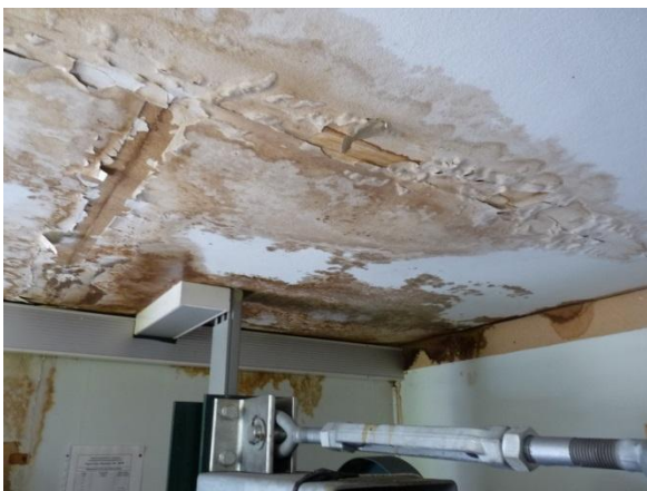
Bild 4: Wannweil-Echaz 2011-08-02 undicht gewordenes Dach im Pegelhaus
