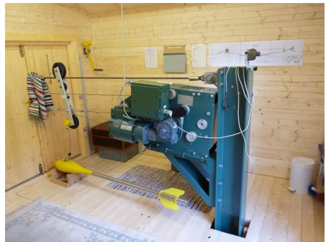
Bild 3: Hundersingen-Donau 2011-06-21 Teil Seilkrananlage im Pegelhaus
