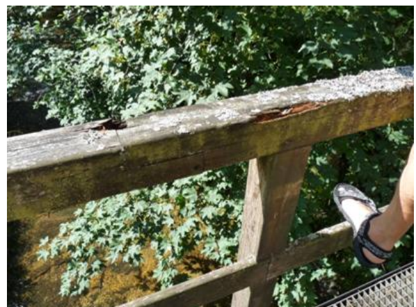
Bild 5: Illmühle-Steina 2011-08-16 maroder Messsteg
