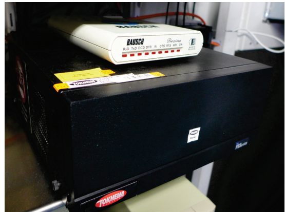
Abbildung 7: Steuerrechner des Kassensystems am Fraunhofer ISE
