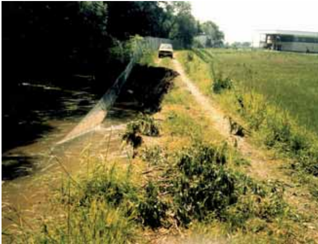
Abb. 4.25 :Wasserseitige Erosion des Deiches
