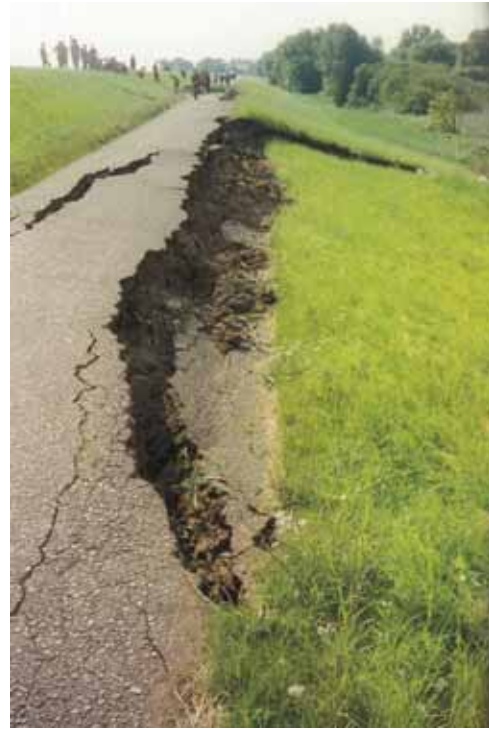
Abb. 4.21: Abrutschen des Deichverteidigungsweg
