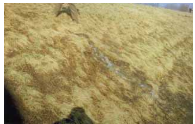
Abb. 2.5: Hoher und kritischer Sickerwasseraustritt aus der landseitigen Böschung
