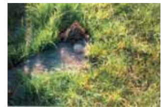
Abb. 4.7: Wasseraustritt am Böschungsfuß (Maulwurf), Oder
