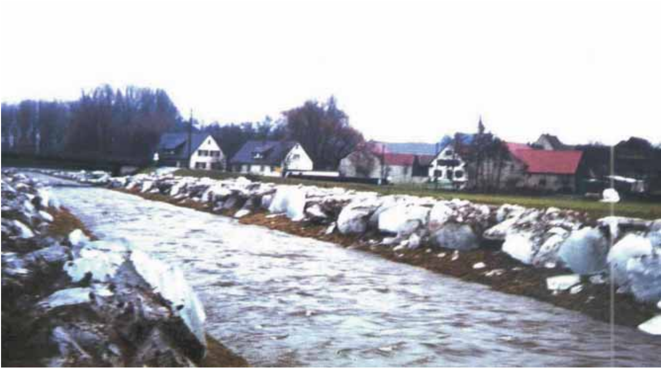
Abb. 4.23: Oberflächige Beschädigung der wasserseitigen Böschung durch Eisgang
