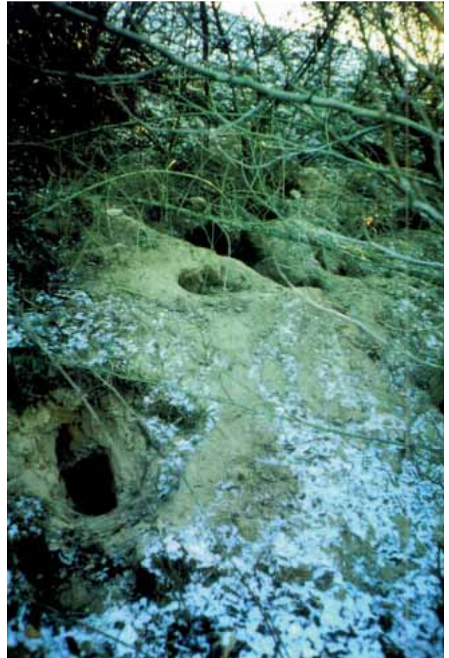
Abb. 2.8: Deichböschung mit Wühltierbefall
