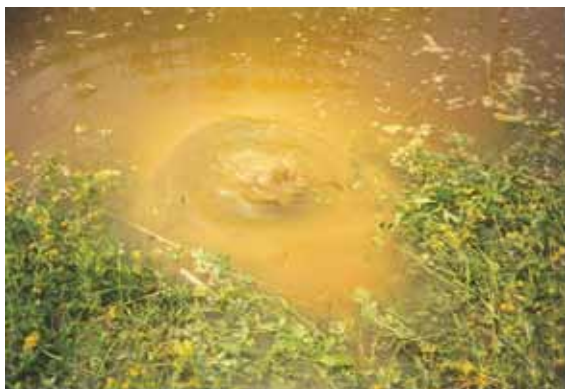
Abb. 4.12: Trübes Sickerwasser in einem luftseitigen Graben
