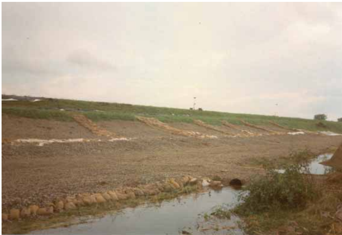
Abb. 5.13: Sandsackquerriegel mit Vorschüttung an der Oder
