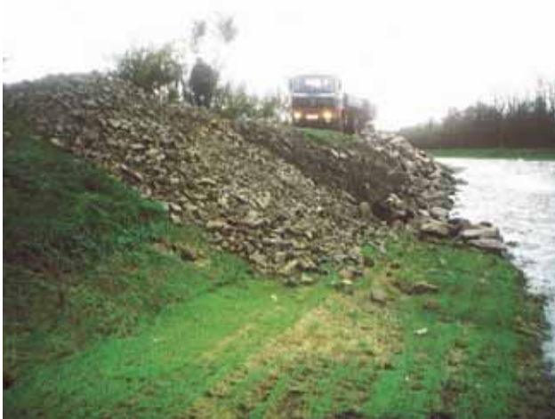
Abb. 3.5: Deichsicherung gegen Erosion durch Steinschüttung an der Rench
