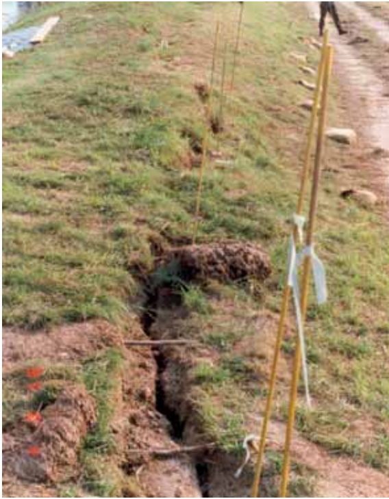
Abb. 4.20: Risse im Deich
