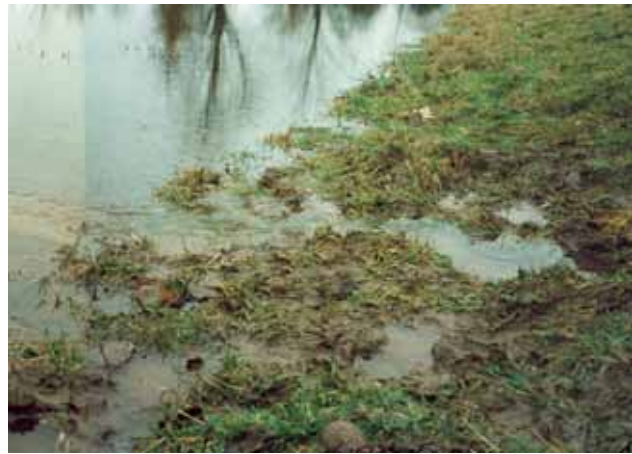
Abb. 4.2: Sickerwasseraustritte am Deichfuß, Kinzig
