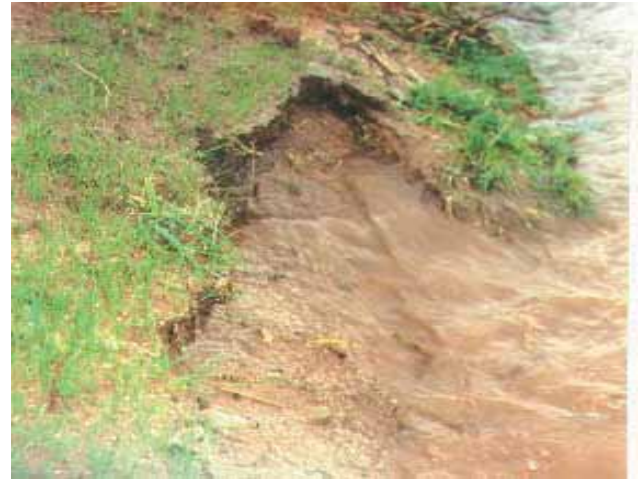
Abb. 4.26: Böschungsschäden durch Wellenschlag
