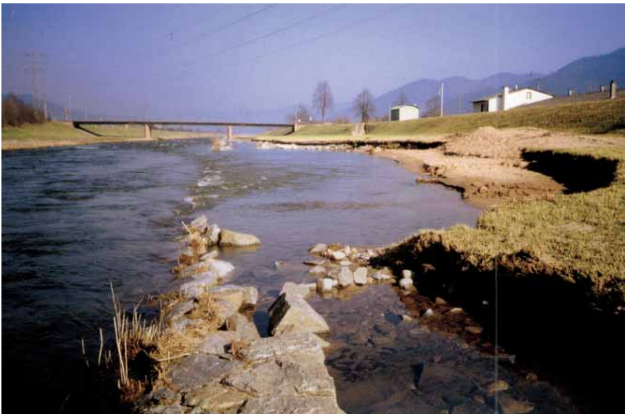
Abb. 4.27: Erosion des Vorlandes an der Kinzig
