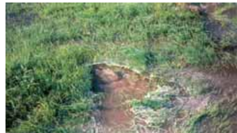
Abb. 4.16: Wasseraustritt im Deichhinterland
