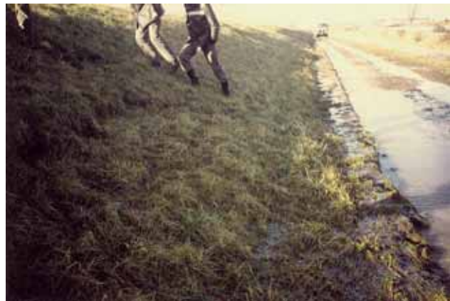
Abb. 4.3: Sickerwasseraustritte in der Deichböschung, Kinzig
