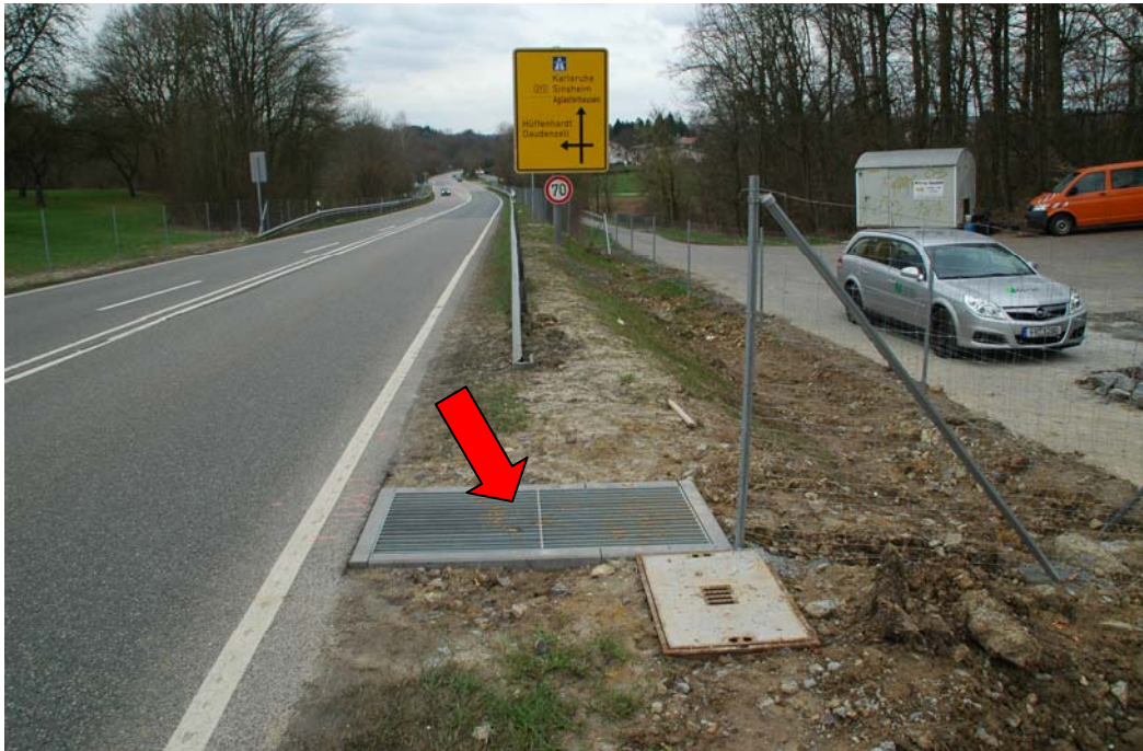
Abb. 2-5: Gitterroste zwischen Zaunende und Fahrbahnrand verringern das Risiko des unbeabsichtigten Eindringens von Wildtieren aus dem Wechselbereich in den Straßenraum mit dem beidseitigen Leitzaun. Wildtiere neigen in den gezäunten Bereichen zu Panikreaktionen, wodurch das Unfallrisiko erheblich ansteigt.
