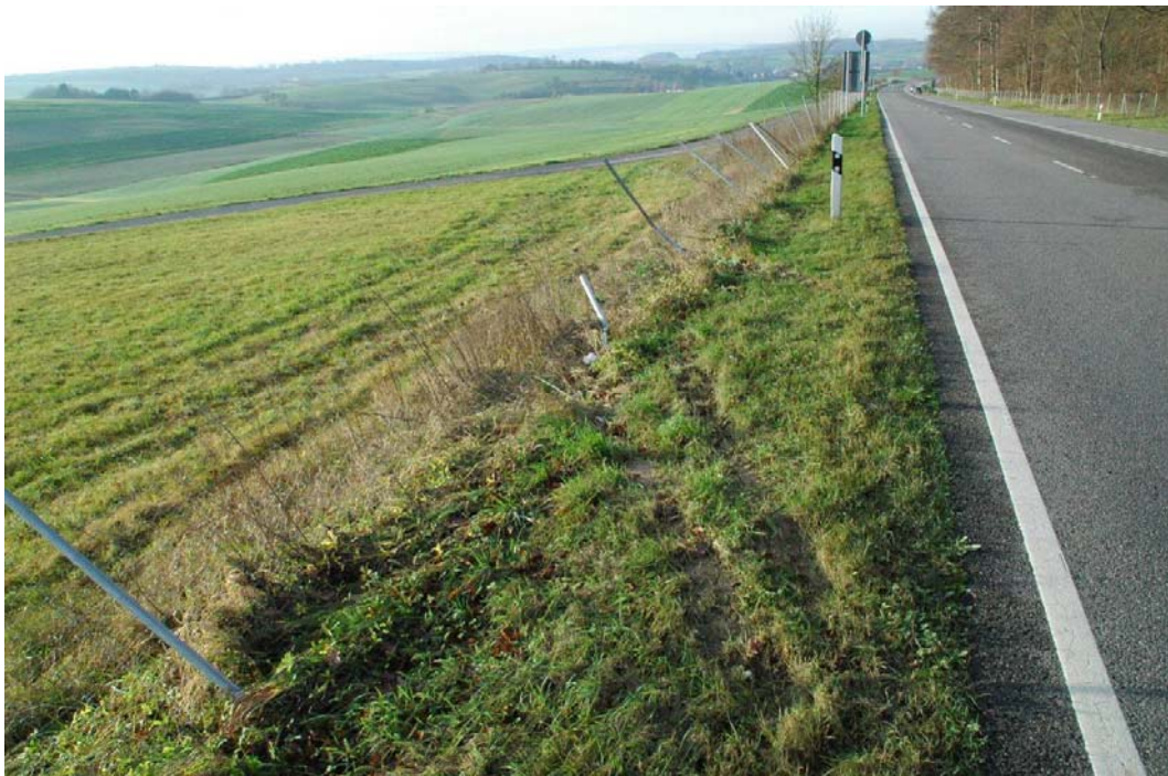
Abb. 6-1: Beschädigter Zaun. Wildtiere können hier leicht auf die Fahrbahn gelangen. Das Risiko für einen Wildunfall steigt somit sehr schnell an. Eine Notreparatur sollte in solchen Fällen umgehend erfolgen.
