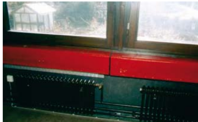
PCB-haltige Dehnungsfuge in einer Fensterbank, ebenso Anschlussfugen Glas-Fensterrahmen
