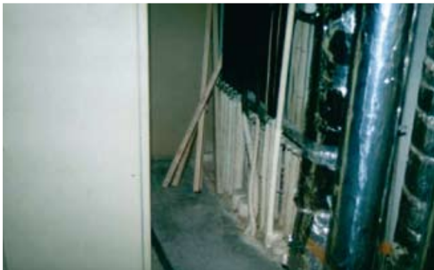
Asbesthaltiger Brandschutzanstrich bei Kabeldurchführungen
