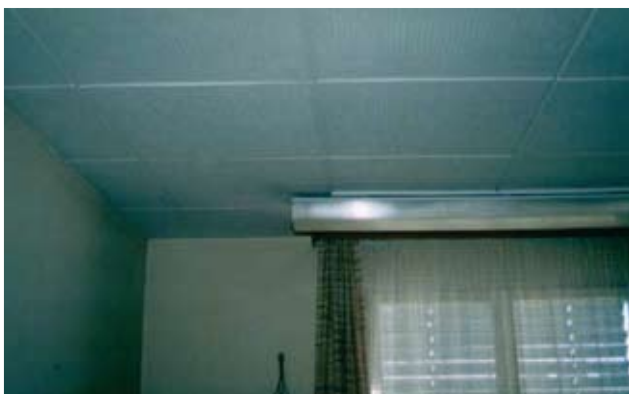
Asbesthaltige Platte zwischen Lampe und Deckenplatte
