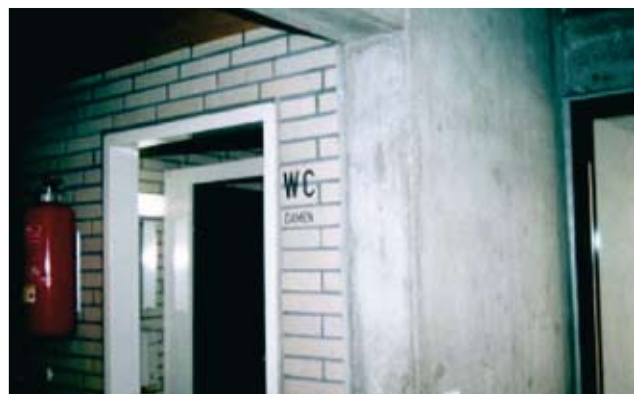
PCB-haltige Fugen um Türrahmen und Anschlussfuge Klinkerwand-Beton
