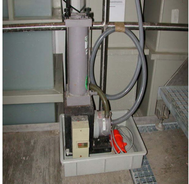
Abb.2 Umwälzpumpe für Elektrolyt
