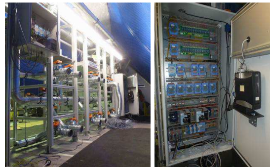
Abb. 95: Verkabelung der Komponenten und der beiden Schaltschränke
