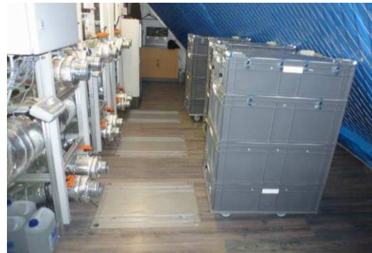
Abb. 97: Abgekoppelte und von den Waagen in den Rangierbereich gezogene Speichermodule
