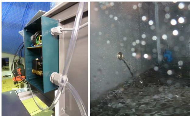
Abb. 124: Automatische Wasserstandsregelung an der Luftbefeuchterbox
