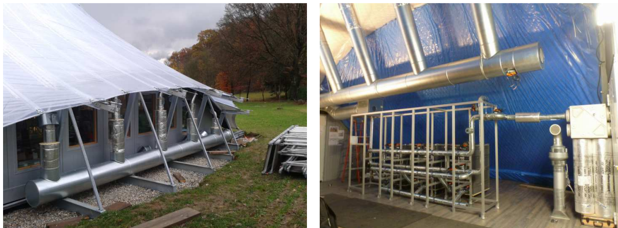
Abb 88: Rohrleitungsisolierung außen (links) und innen (rechts)
