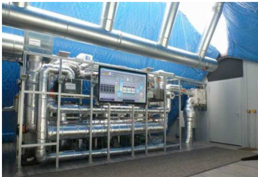
Abb. 96: Speicher-Heizungs-System mit Anlagenanzeige im Betrieb
