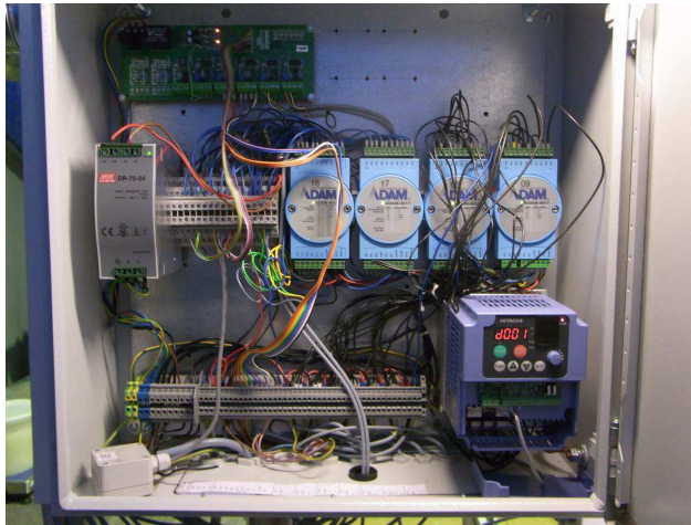
Abb. 106: Schaltschrank mit den ADAM-Modulen, einem Analogverstärker des Labor Blum, sowie einem Netzteil und dem hier noch installierten Frequenzumrichter.
