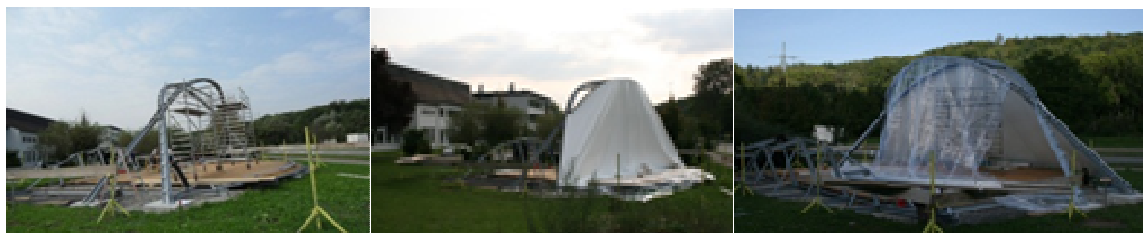
Abb. 75: Stahlbau (links), PVC-Gewebe an der Nordseite (Mitte), Transparente Außenhaut für die Südseite (rechts)
