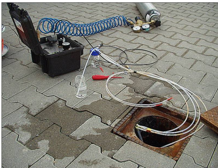
Abbildung 35 Grundwasserprobennahme mit den eingebauten pneumatischen Pumpen
