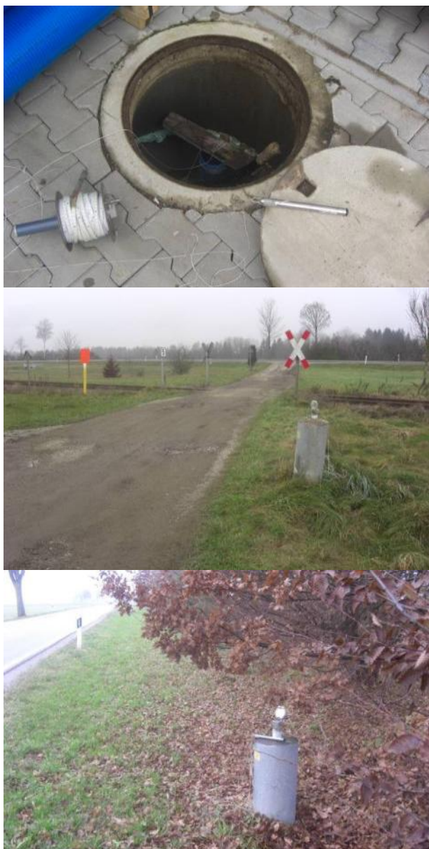
Abbildung 8 Messstellen M1 (oben), M2 (mitte) und M3 (unten) zur kontinuierlichen Druckmessung
