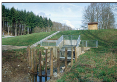
Abbildung 8.2: Einlauf mit Rechen.
