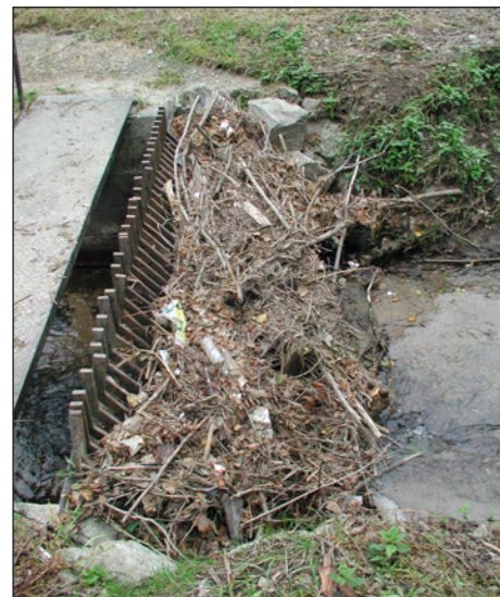
Abbildung 7.43: Verklausung am Hochwasserrückhaltebecken Freiburg Nord.
