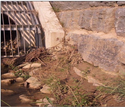
Abbildung 6.18: Sedimenteintrag nach Einstauereignis am Hochwasserrückhaltebecken S43.
