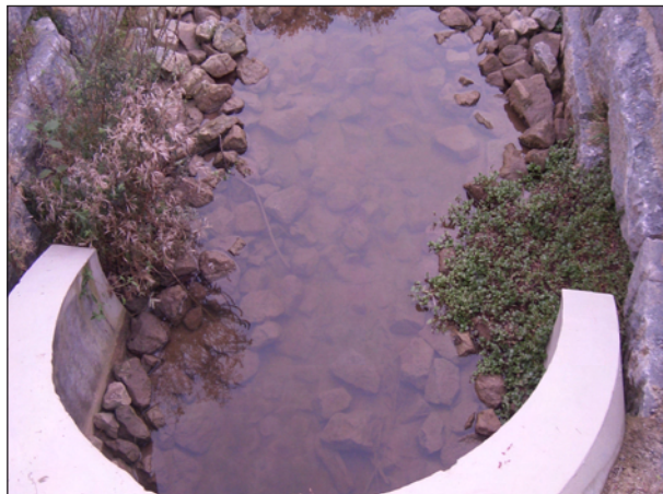
Abbildung 7.37: Verschlammter Auslassbereich am Hochwasserrückhaltebecken Insenbach S43.
