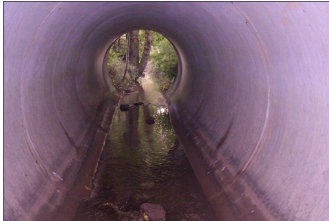
Abbildung 7.45: Die Verrohrung unterhalb des Hochwasserrückhaltebeckens weist keine durchgehendes Sohlsubstrat auf.
