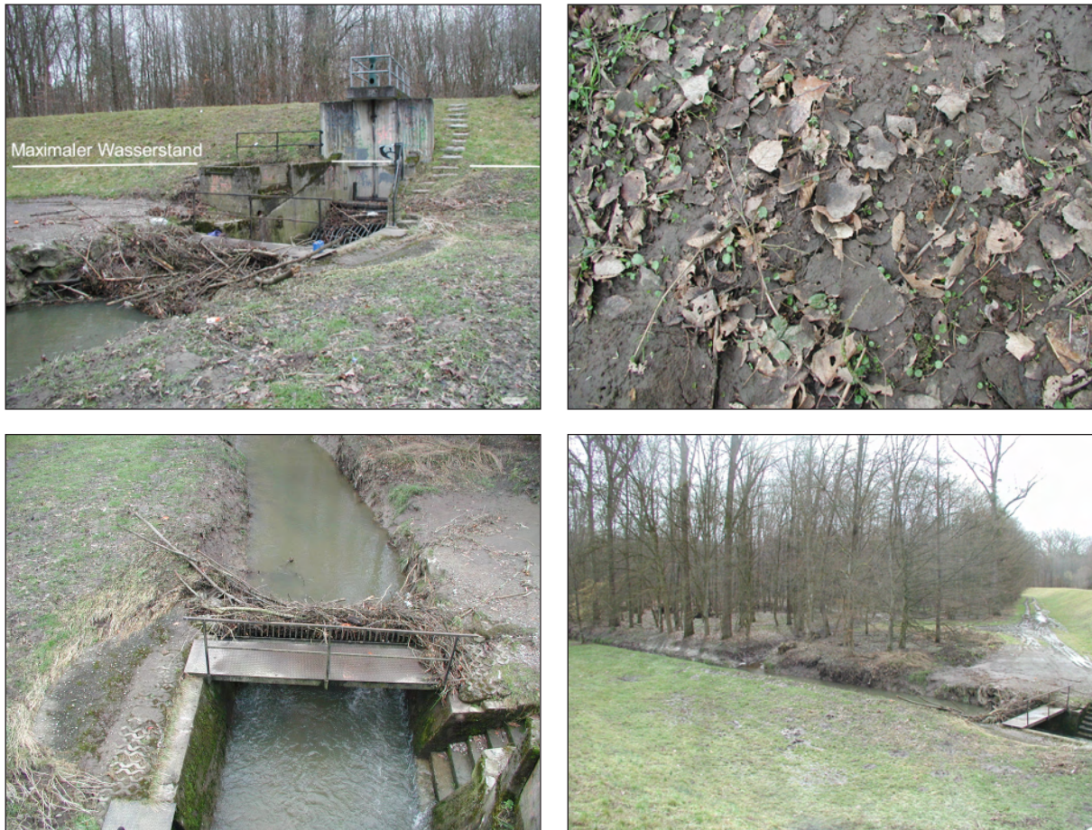
Abbildung 6.16: Das Rückhaltebecken Freiburg Nord am Schobbach nach dem Einstau vom 8.-9. März 2006. Das Becken war nur zum Teil gefüllt (Bild links oben), dennoch wurde eine große Menge Geschwemmsel und Schlamm abgelagert (die Bilder wurden am 10. März aufgenommen).
