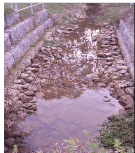
Abbildung 7.44: unterer Durchlassbereich am Hochwasserrückhaltebecken S43 mit zu breitem Mittelwasserbett.
