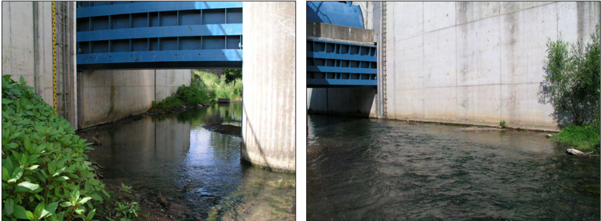
Abbildung 7.32: Hochwasserrückhaltebecken Bernau. Einlauf rechts- und linksseitig. Im Durchlass sind keine terrestrischen Habitate vorhanden. Tiere können sich hier nur schwimmend fortbewegen. (SCHWENNINGER).
