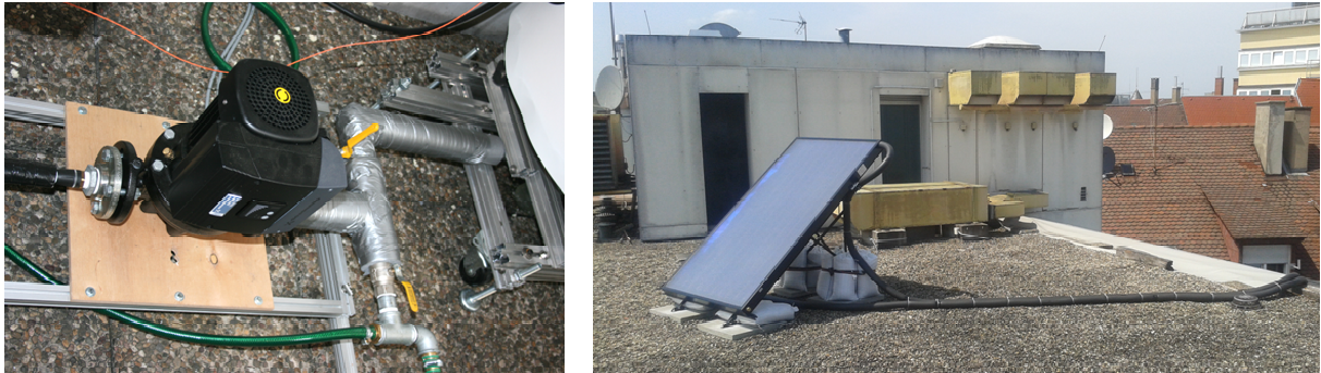
Abbildung 26: Installierte zentrale Pumpe und Solarkollektor
