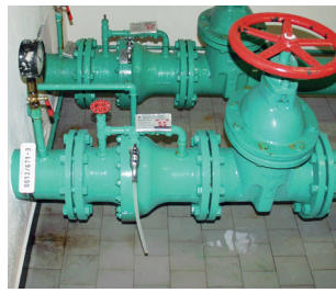
Abbildung 1.2-2: Rohwassermessstelle im Wasserwerk
