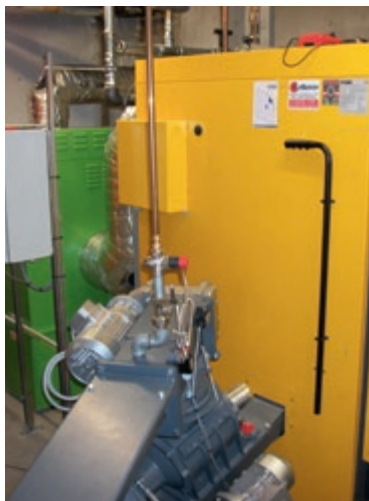
Heizanlage mit einem elektrostatischen Partikelabscheider (grün), der über ein Kammer-System mit speziellen Komponenten verfügt, die Filtergewebe oder ein Rauchgasgebläse überflüssig machen.
