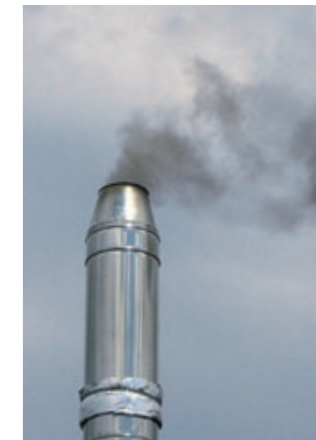
Rauchgase müssen frei abziehen können.
