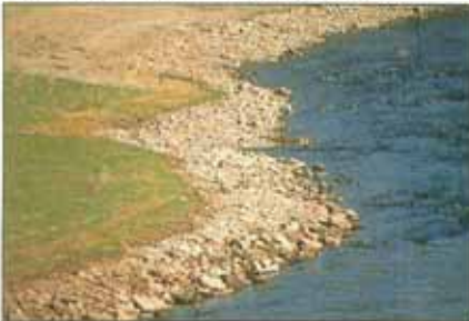
Die Uferlinien wurden mit Steinwurf und/oder mit ingenieurbioologischen Bauweisen gesichert. Mit den Ergebnissen des Modellversuchs konnte eine differenzierte Bemessung der Ufersicherungen vorgenommen werden (Mayer-Peters 10/90).
