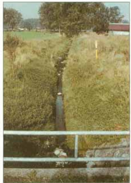
Eine langgestreckte strukturlose Betonrinne, allenfalls hydraulischen Ansprüchen genügend, war kennzeichnend für den Rebbach/Böglebach vor den Umgestaltungsmaßnahmen (Mander 6/89).
