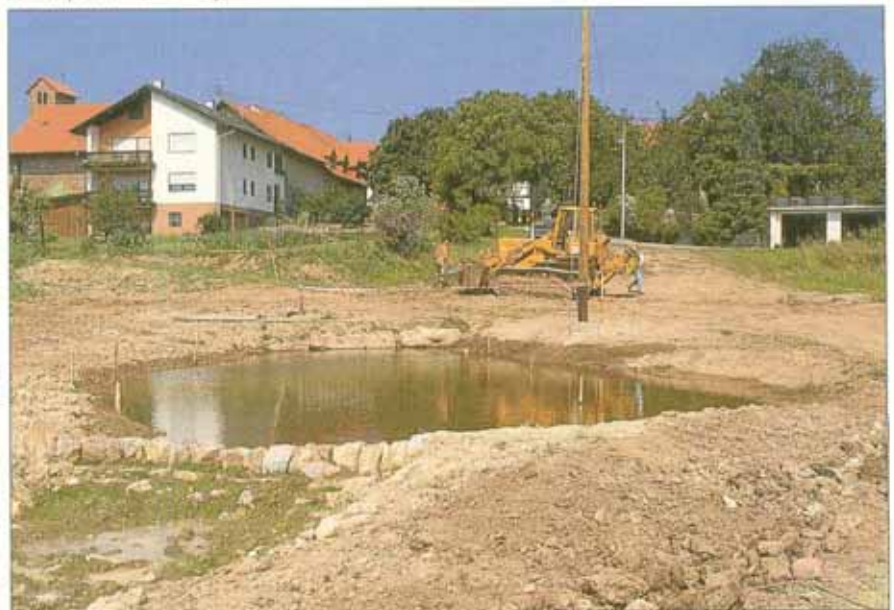
Zur Verhinderung von Erosionsschäden durch Regenüberläufe wurde am Ortsrand ein Kolksee angelegt, dessen Auskleidung mit Blöcken aus anstehendem Material vorgenommen werden konnte (Bostelmann 7/91).
