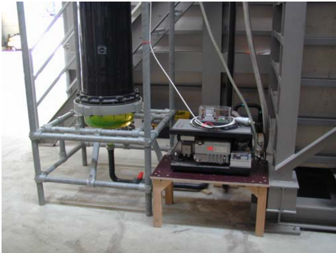
Abbildung 12: Automatische Entlüftung – Niveausteuern und Vakuumpumpe
