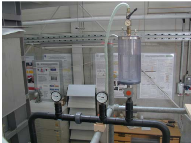
Abbildung 11: Automatische Entlüftung – Wasserbehälter am Hochpunkt der Anlage mit Verbindung zur Vakuumpumpe)
