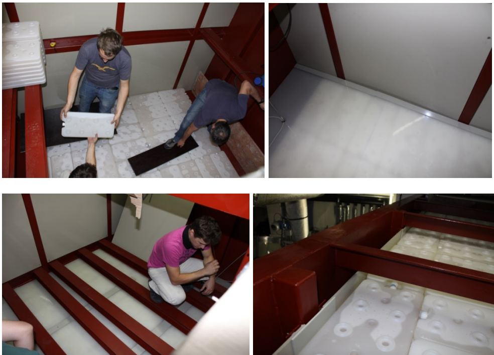
Abbildung 72: Aufbau des hybriden Latentwärmespeichers. Im Uhrzeigersinn von links oben: Einstapeln der FlatIce-Kapseln, Trennplatte zur Strömungsführung. Zwischenträger zum Abfangen des Gewichts der oberen Hälfte der Kapseln. Fertig mit Kapseln befüllter Latentwärmespeicher
