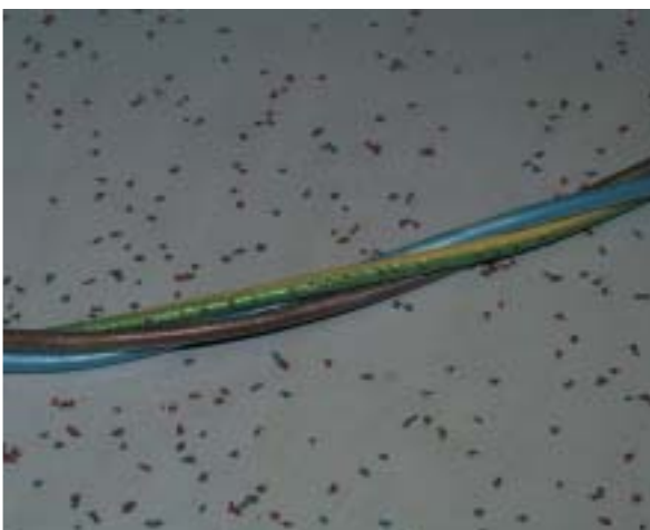
Abbildung 6.1-6 Gebrochene innere Isolierung
