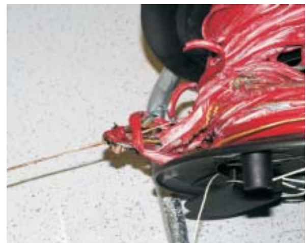
Abbildung 6.1-7 Blanke innere Leitungen
