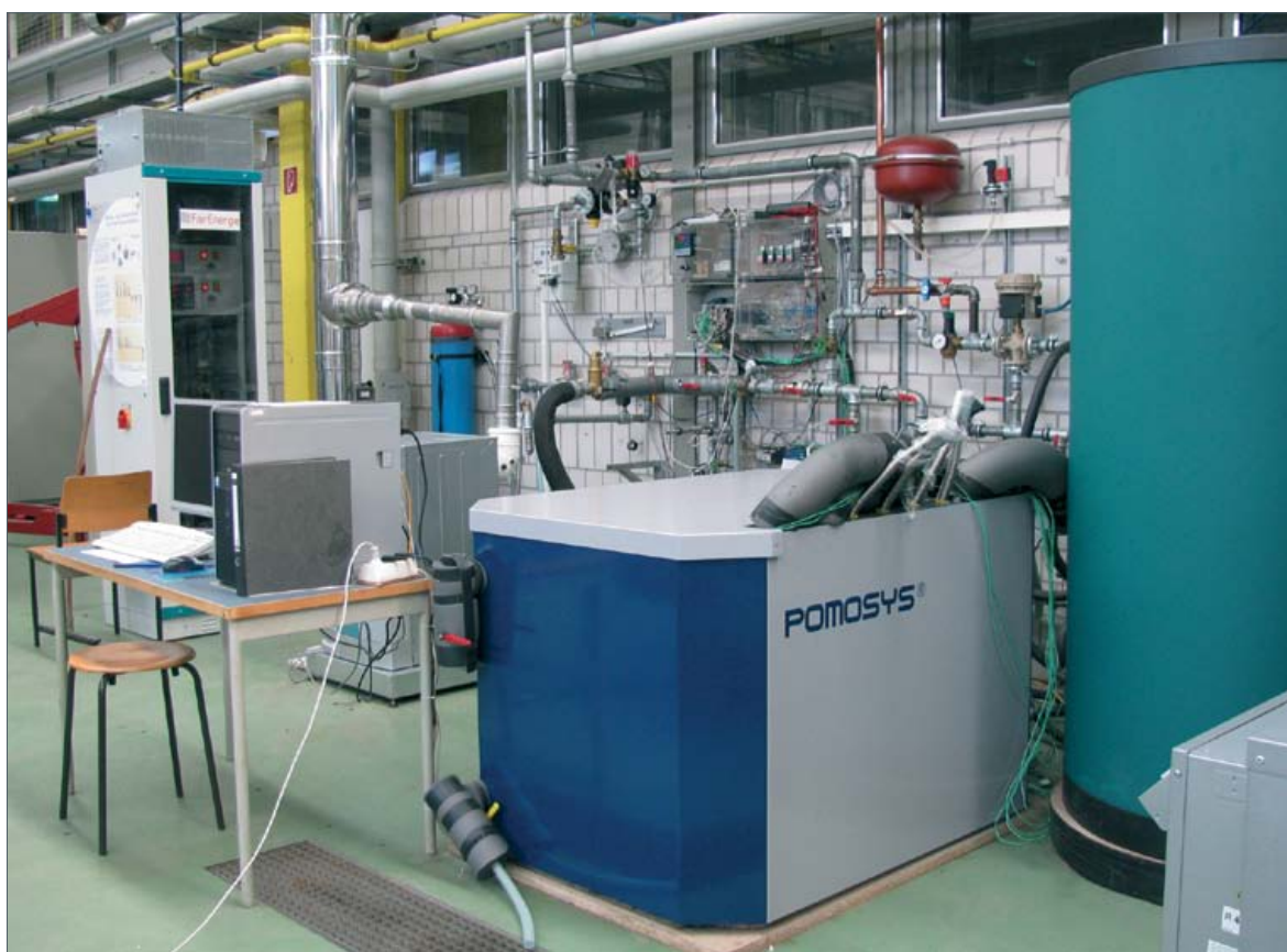
Mikro-KWK-Gerät (im Vordergrund) und gleich hoher Latentwärmespeicher am Prüfstand im Reutlingen Research Institute
