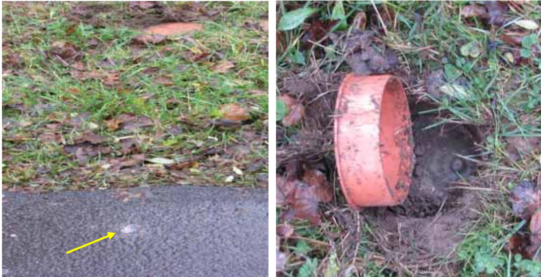
Abgesenkter Vermessungspunkt mit KG-Abdeckkappe beim HRB Diebach (gelber Pfeil Markierung auf der Straße)
