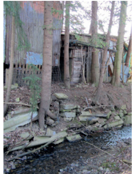
Abb. 2.2: Bauliche Anlagen stellen oftmals einen rechts- oder ordnungswidrigen Zustand dar.
