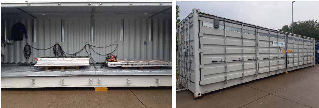
Abbildung 61: Gelkoh-Container auf dem Betriebsgelände der ERLOS, Links: geschlossener Container in Aussenansicht, Rechts: Akkus während der Entladung im gezeigten Container.
