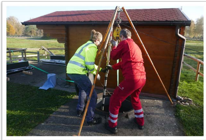
Abb. 10: Abschluss der Bohrlochmessung. Bergen eines Logging Tools aus der GB 2. KIT-Werkstattleiter Kevin Altinger mit Eduard Scheck von BLM.
