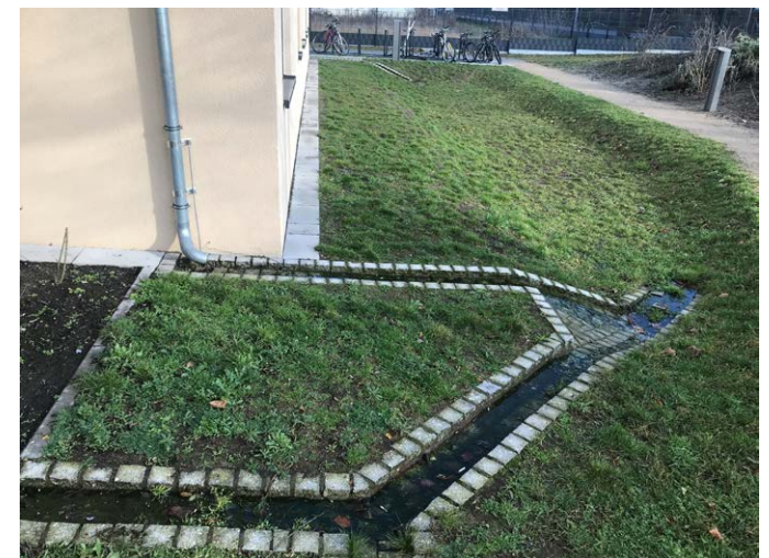
Abbildung 17: Ableitung des Dachflächenwassers über offene Rinnen in Rasenmulden (Foto: Wolfram Schroff)
