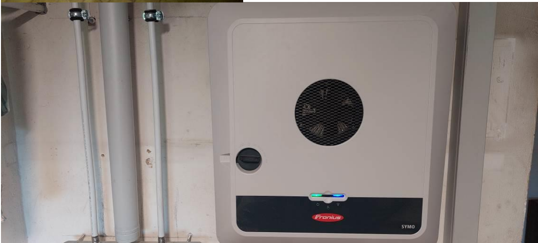
Schaltschrank, Batteriespeicher und Wechselrichter im Untergeschoss
