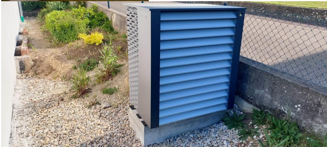
Luft-Wärmepumpe Untergeschoss mit Außengerät
