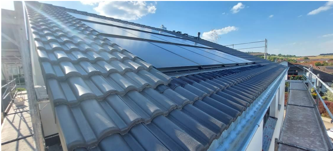
Gedecktes Dach mit Indach PV-System
