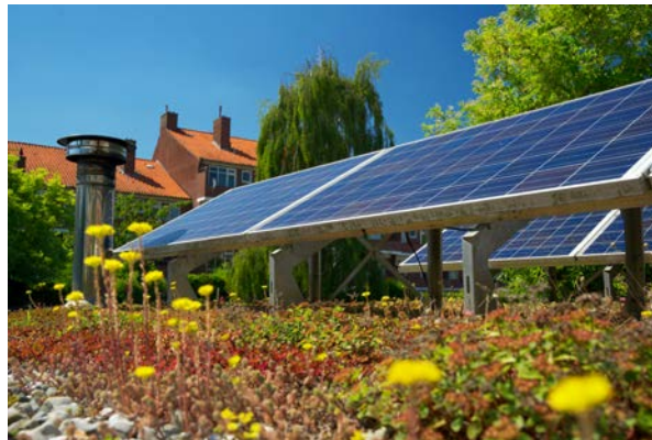
Abbildung 3: Dachbegrünung kombiniert mit aufgeständelter Photovoltaikanlage (Foto: Rene Notenbomer, stock.adobe.com)
