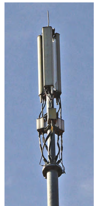
Abb. 59: Antennenkonstellation einer typischen Mobilfunkbasisstation mit drei Sektorantennen.
