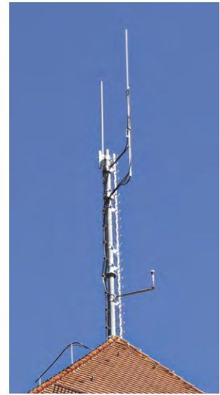
Abb. 64: TETRA-Mobilfunkmast mit Rundstrahlantenne.
