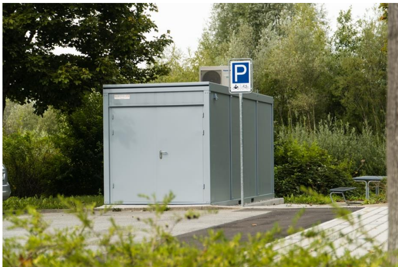
Abbildung 14: Container mit Batterie, Leistungselektronik und Kommunikationstechnik 33
