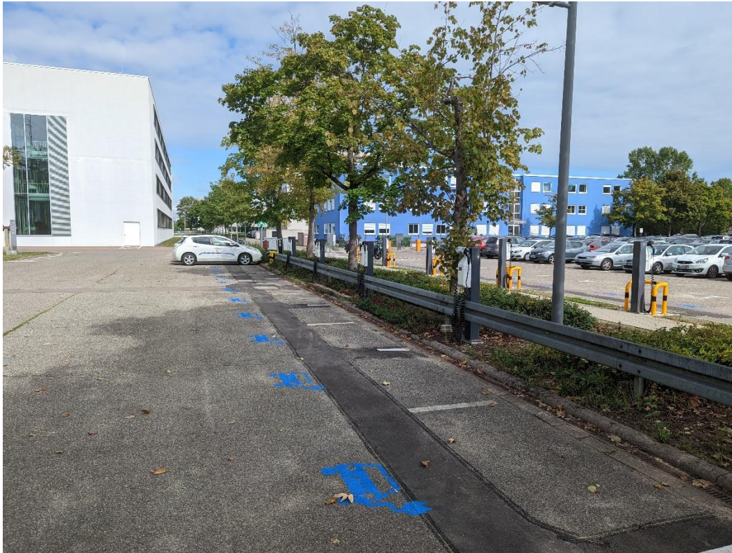
Abbildung 10: Blick auf die Ladeinfrastruktur Ostseite mit den 5 Stelen bzw. 10 Ladepunkten für Mitarbeiter
