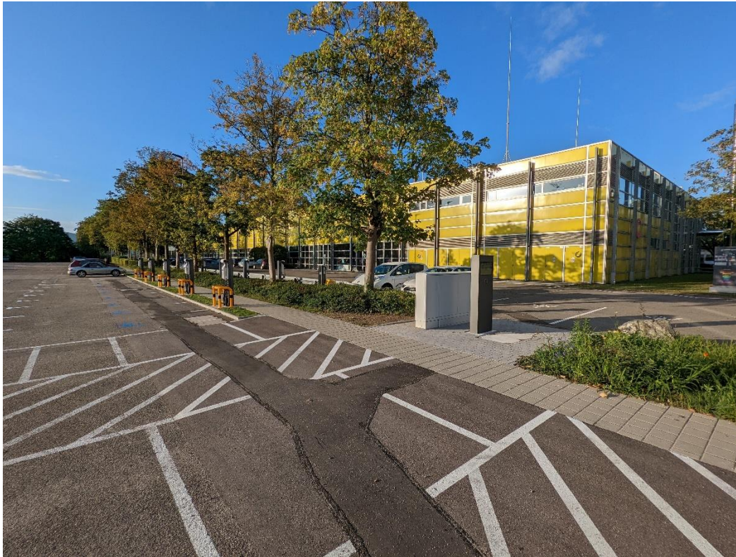
Abbildung 8: Blick auf die Ladeinfrastruktur vom Westen mit den westlichen 5 Stelen bzw. 10 Ladepunkten
