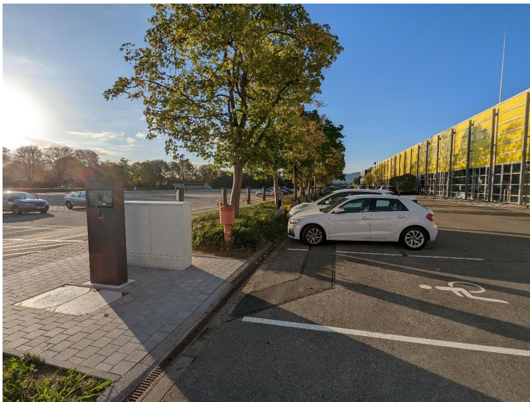
Abbildung 7: Blick auf die Ladeinfrastruktur von der Nordseite - ChargePanel und ChargeBase
