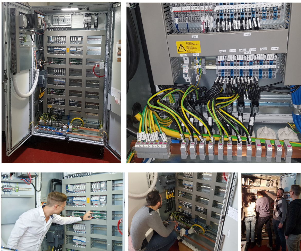
Abbildung 41: Zentraler Schaltschrank von chargeBIG für 15 einphasige Ladeanschlüsse und einen dreiphasigen Ladepunkt. Abnahme und Einweisung durch Mahle chargeBIG-Mitarbeiter.
