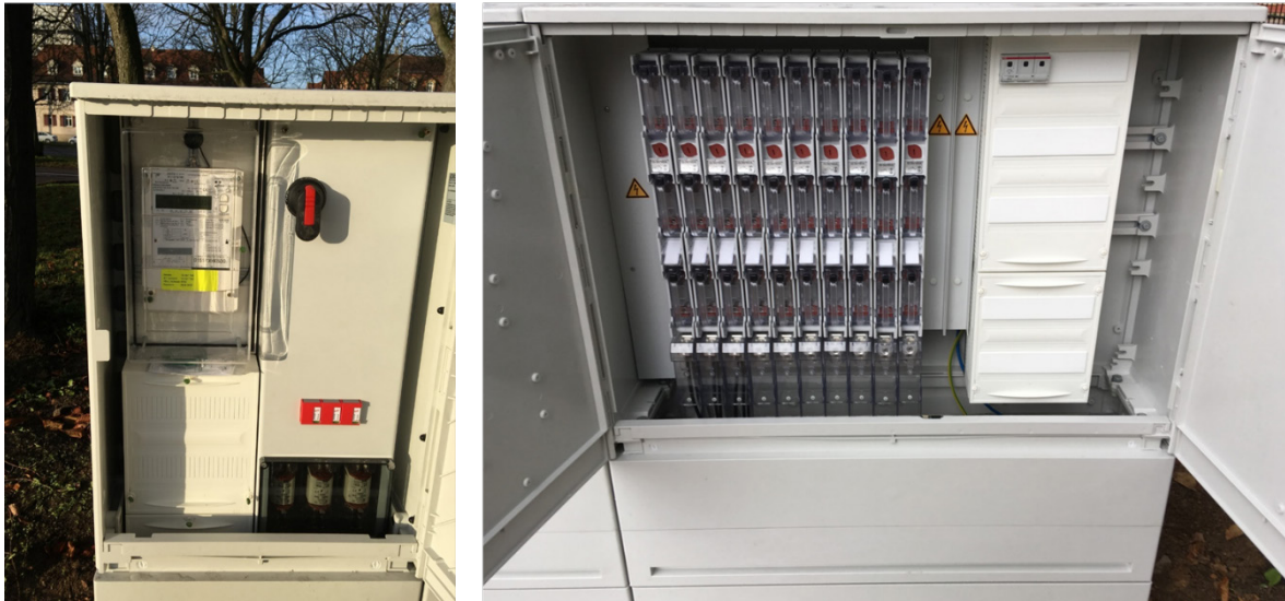
Abbildung 2: ZAS des Netzbetreibers (links) und Unterverteilung des LIS-Betreibers (rechts)
