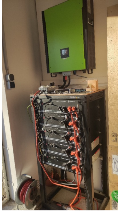
Abbildung 54: Wechselrichter mit angeschlossenem Batteriespeicher
