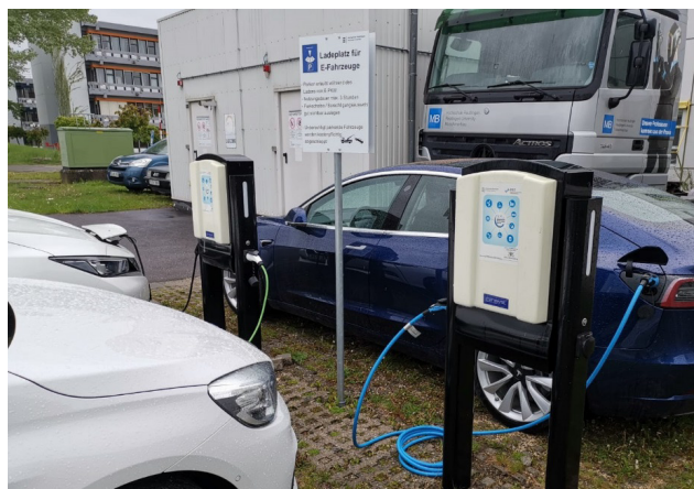
Abbildung 5: Bestehende Ladeinfrastruktur aus dem Demonstrationsprojekt Virtuelles Kraftwerk Neckar-Alb an der Hochschule Reutlingen.
