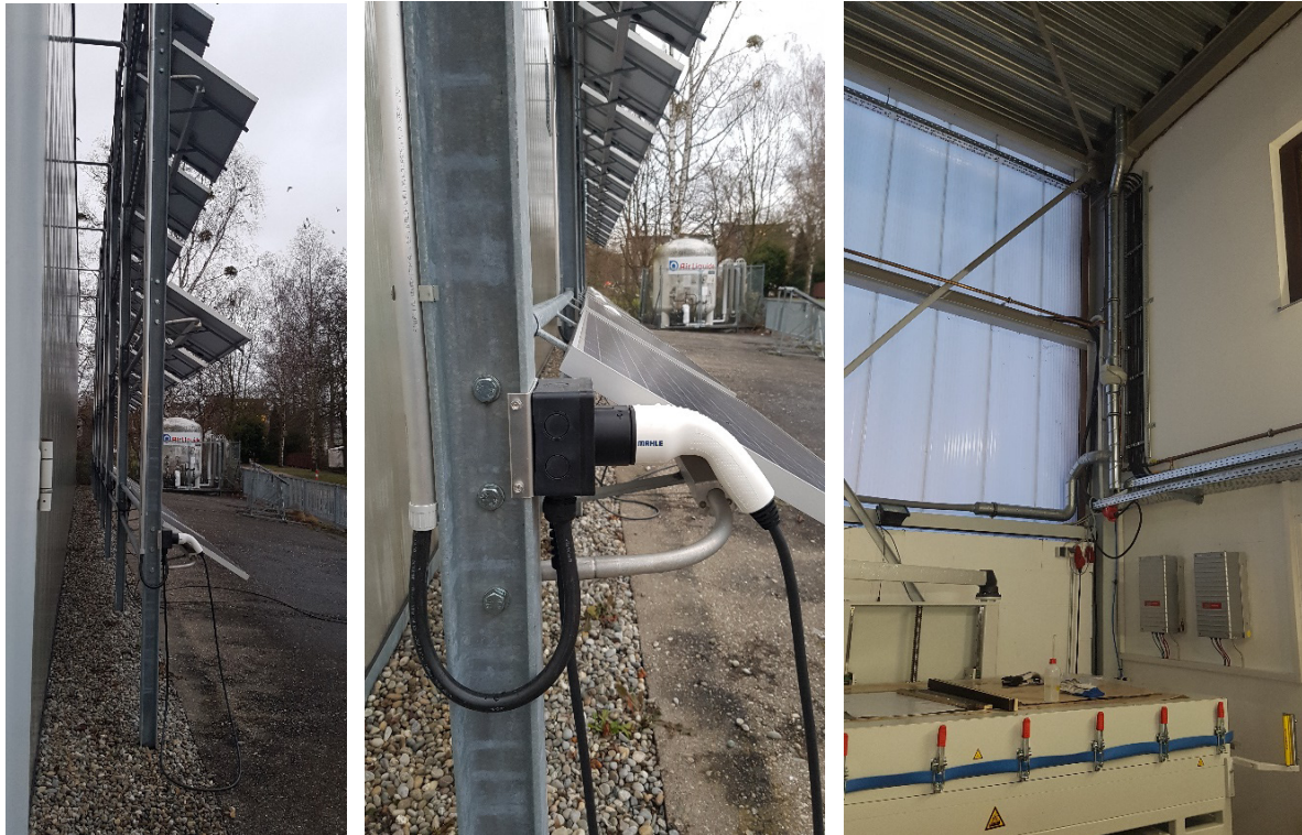
Abbildung 42: Fest angeschlagene Leitungen mit Typ II Ladesteckern an der PV-Fassade. Im rechten Bild ist die Leitungsführung über Kabeltrassen und eine Steigleiter zu sehen.
