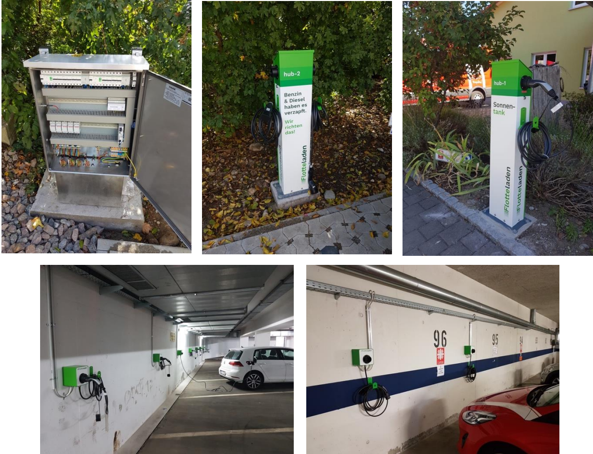
Abbildung 10 – Installation des Ladeparks im Caritasverband Hochrhein
