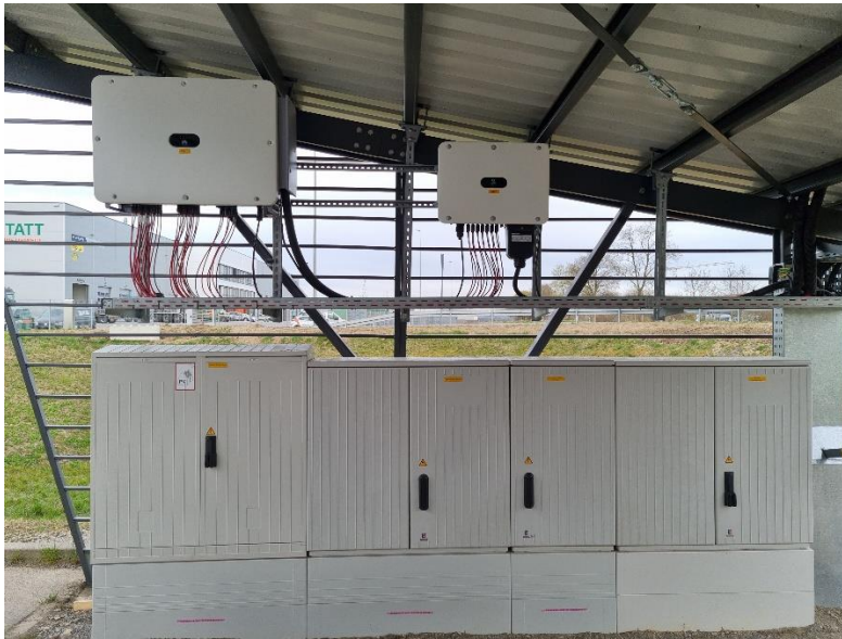
Abbildung 5: Wechselrichter und Schaltschränke unterhalb des Carports
