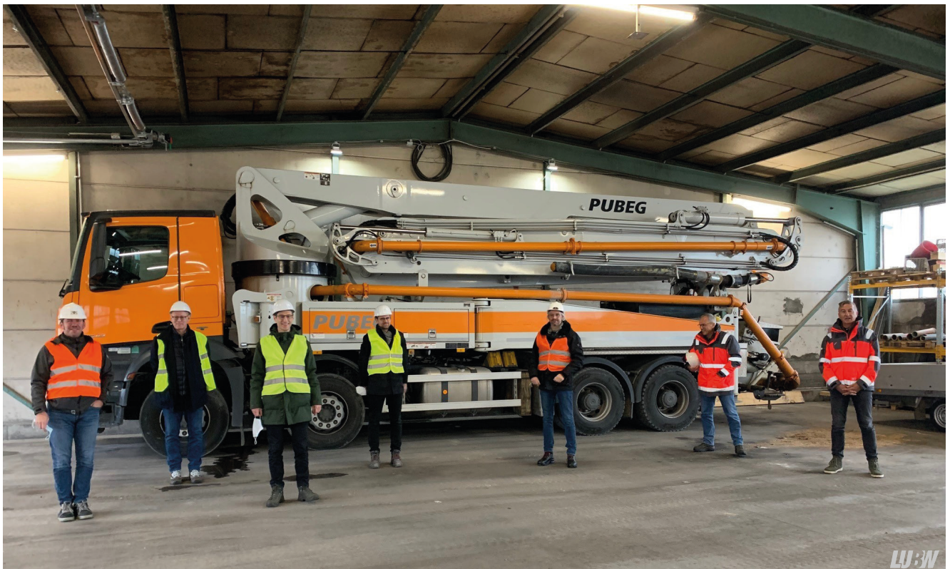
Abb. 1.1: Vertreterinnen und Vertreter der LUBW, des Umweltministeriums und der Betonlieferfirma vor Betonpumpe in einer Halle. Bildnachweis: LUBW
