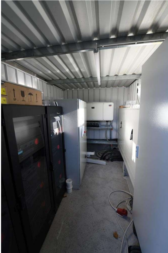
Abbildung 5: Der Pufferspeicher im Technikgebäude
