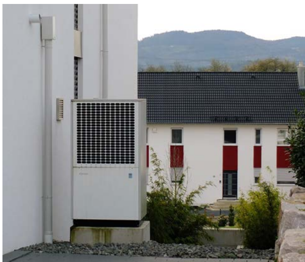
Abb. 7.4-2: Luftwärmepumpe vor einem Wohngebäude. Foto: LUBW.
