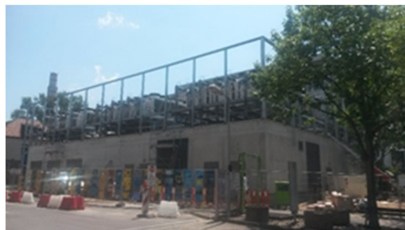
Abbildung 66: Kompressionskältemaschine (6 MW) am Städtisches Klinikum Karlsruhe (Blum, 2017).
