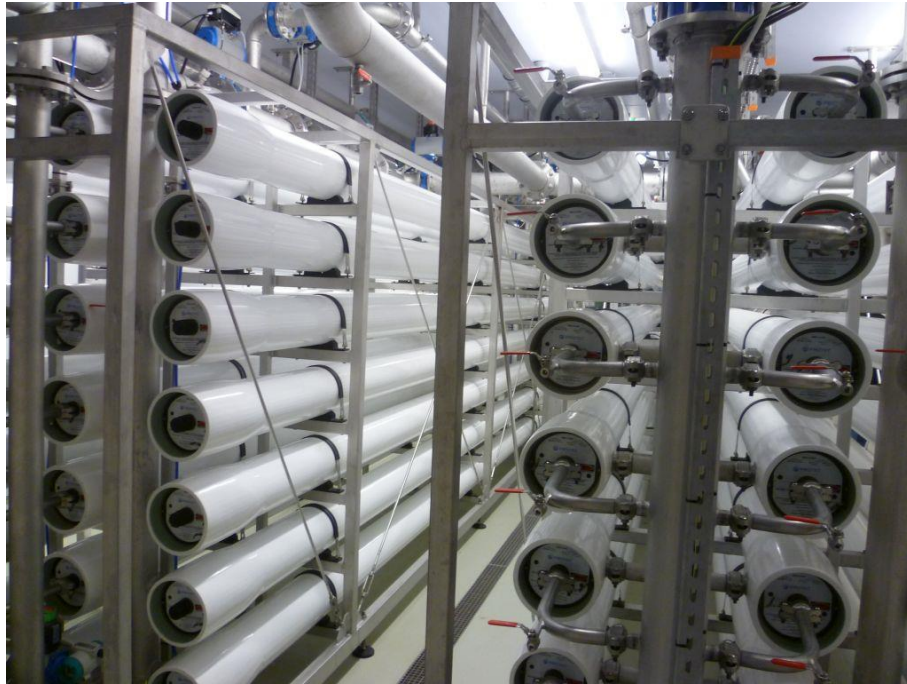
Bild 3: Druckrohre mit UF-Membranmodulen in einem Wasserwerk; Quelle: TZW
